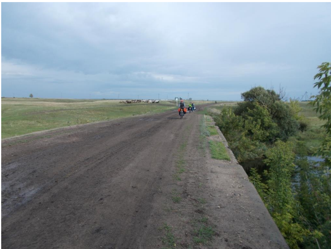
Фото 49, мост чрез речку Таволожка, перед с. Павловка, мост имеет опасность, связанную с отсутствием ограждений
