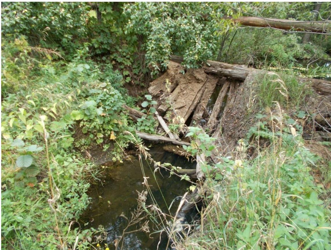
Место переправы по разрушенной плотине на р. Чардым
