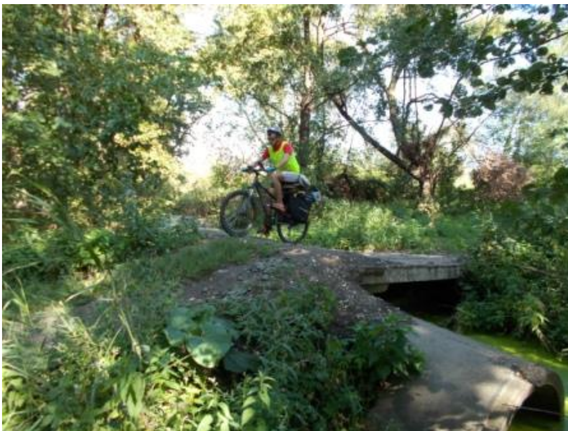
Фото 81, старые гидротехнические сооружения , видимо отстойники, судя по запаху, р-н с. Новая Осиповка
